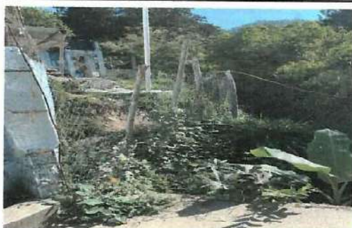
Foto 1: En esta fotografía se ve la falta de construcción de muro de contención para evitar que el agua en el invierno se lleve la malla y destruya parte de edificio del establecimiento
